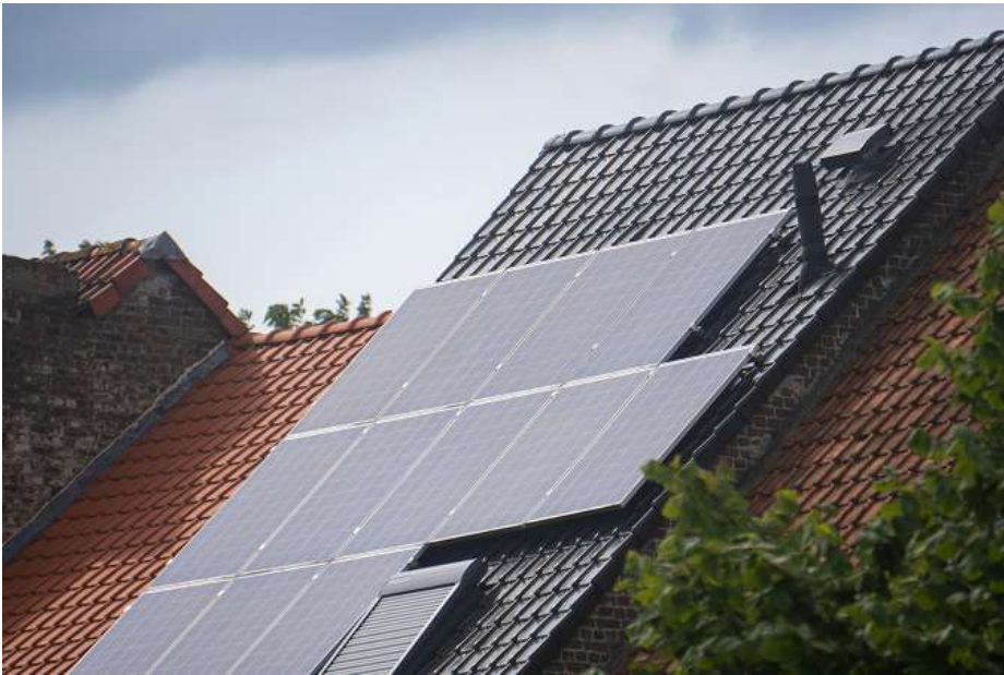
(Bildlegende:) Fotovoltaikanlage auf Einfamilienhaus
